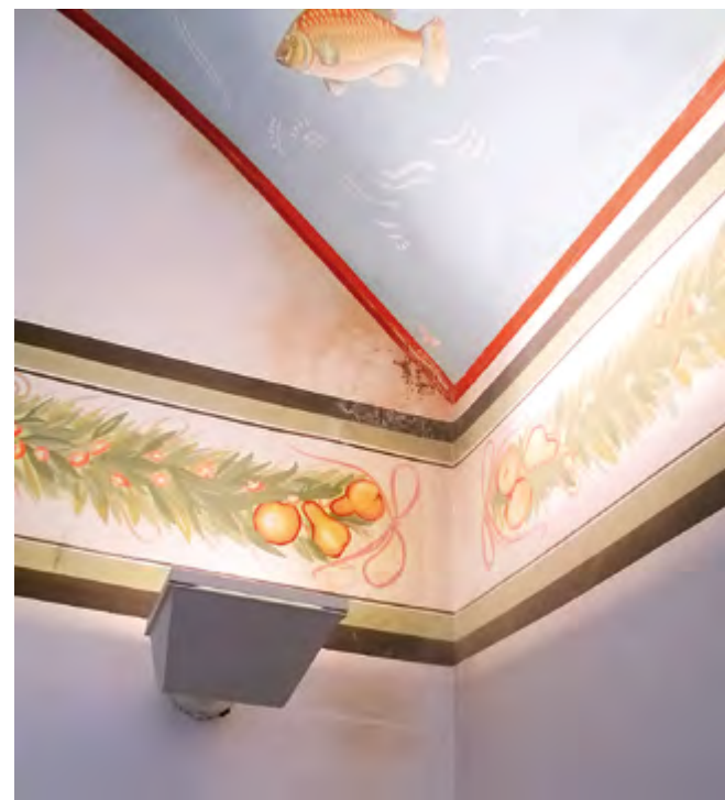
Wykwit na ścianach łaźni
